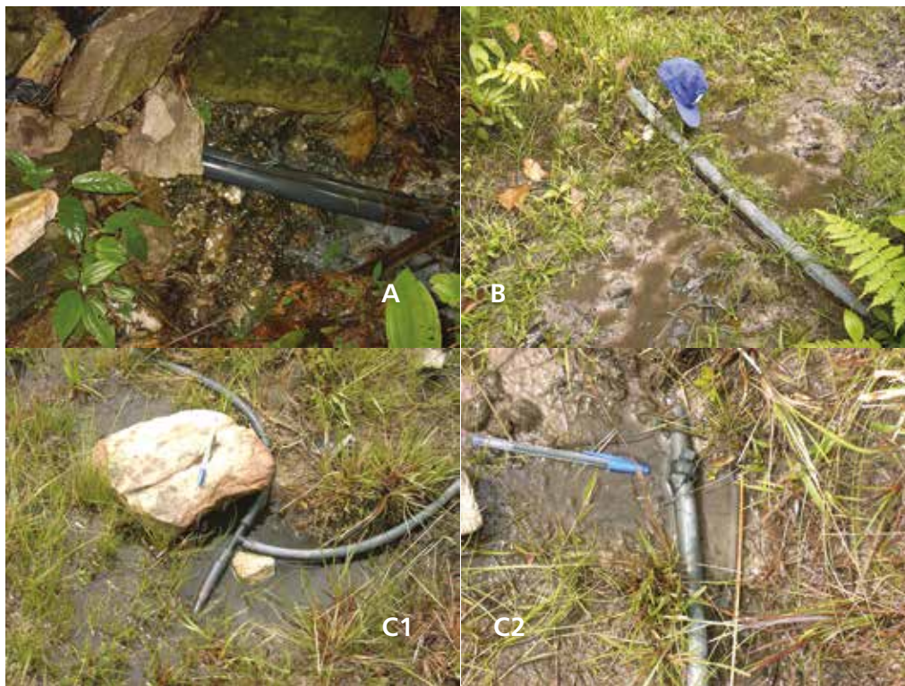
Figura 3. Conexões da rede hídrica da localidade rural Engenho II: encanamento principal (A e B) e residência do óbito (C1 e C2), Engenho II, Cavalcante, Goiás
